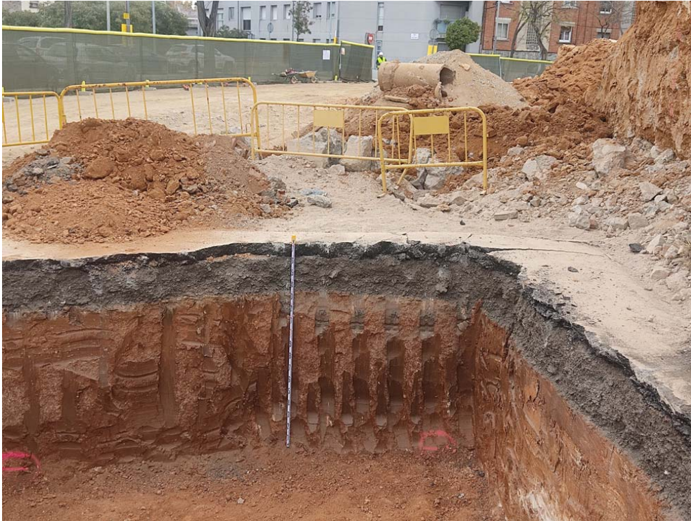
FOTOGRAFIA 22 → Vista de detall de la gran cala excavada per la instal·lació de la grua de l'obra, des de l'est.
