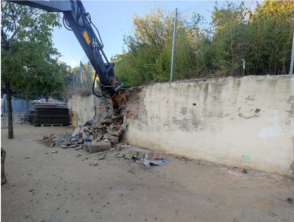
FOTOGRAFIA 13 → Vista de la màquina enderrocant el mur perimetral inferior de l'antiga presó de Dones de la Trinitat (UE103), a la zona més a l'oest, des del sud-est.
