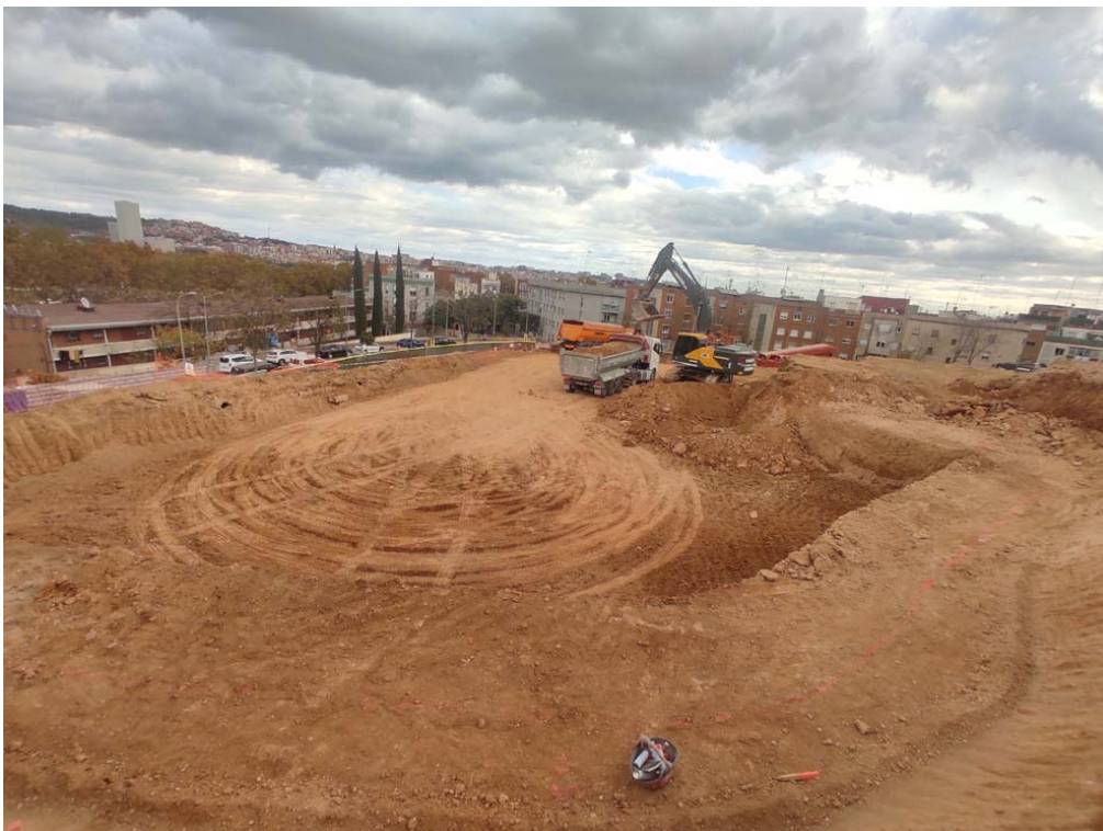
FOTOGRAFIA 25 → Vista panoràmica dels terrenys, amb bona part del rebaix definitiu del subsol acabat, des de l'est.
