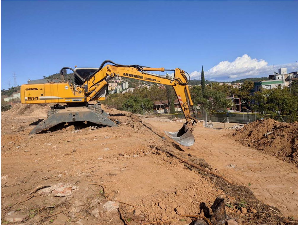
FOTOGRAFIA 16 → Vista de les tasques inicials de rebaix del terreny, on observem la màquina giratòria, preparant el terreny en diverses terrasses, per posteriorment, poder anar excavant el subsol, des de l'oest.
