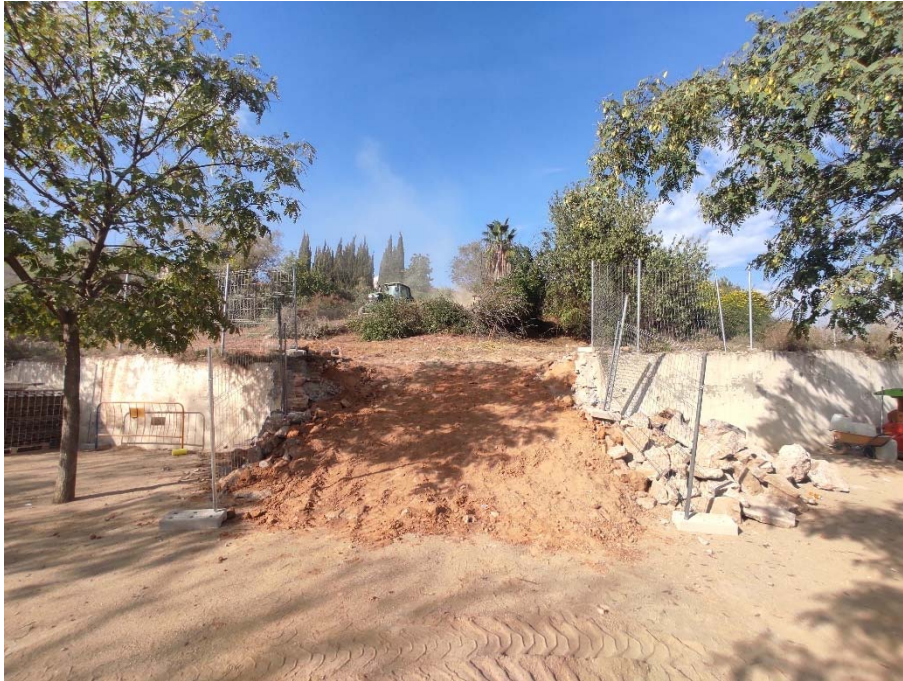
Vista de l'obertura d'un accés al mur perimetral de l'antiga presó de Dones de la Trinitat. (Foto: Òscar Matas).
